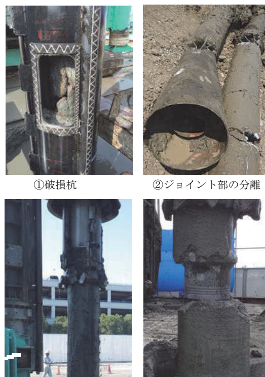
図-3 破損・分離しやすい既存杭の例
